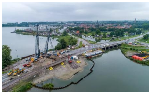
Figuur 1 Gemaal Monnickendam
